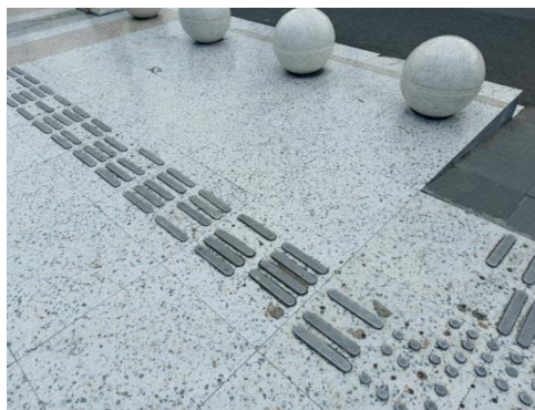
Gambar 1. pelat besi guiding block yang tidak utuh
